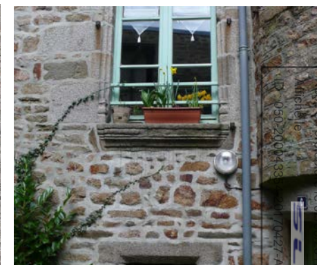
Exemple de jointoiments à éviter
