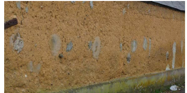
Mur de bâtiment agricole monté à la terre
