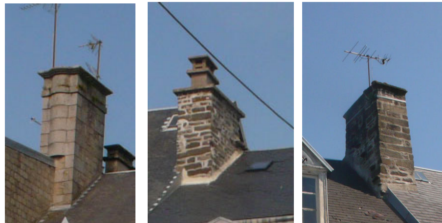
Cheminées en pierre de taille ou maçonnerie antérieure indiquant la conservation de murs pignons antérieurs à la façade sur rue
